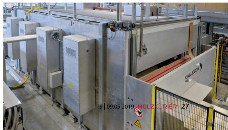
Hochfrequenz-pressen: Die Presse arbeitet kontinuierlich und kann rasch gerüstet werden
